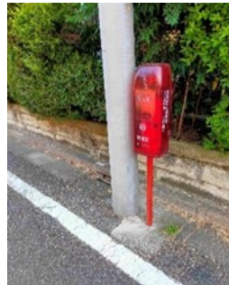
&lt;街頭消火器点検&gt;
