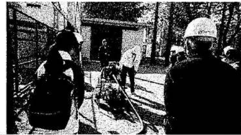
① D級ポンプ稼働
